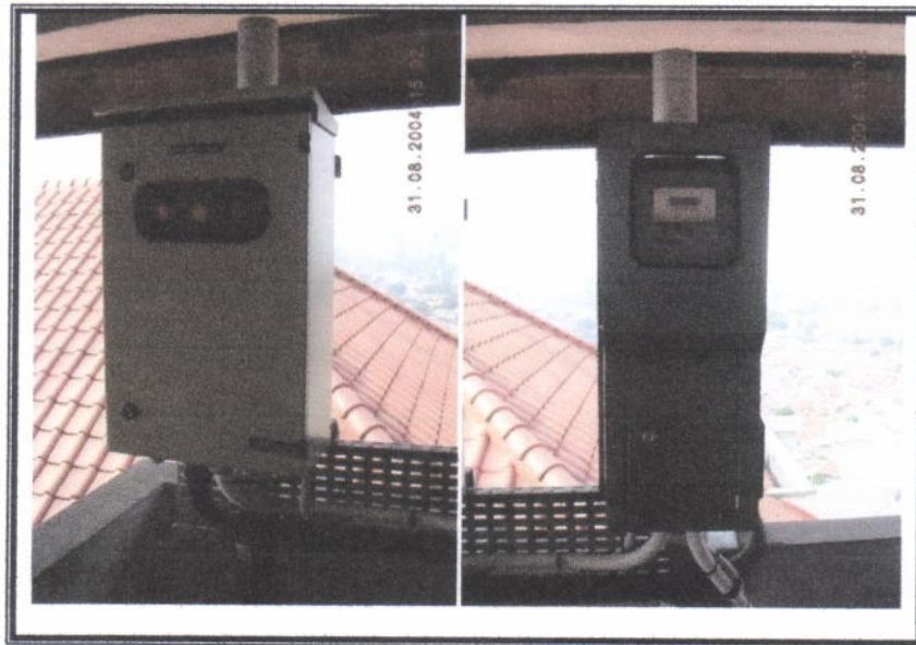
ACPDB & KWh Meter
